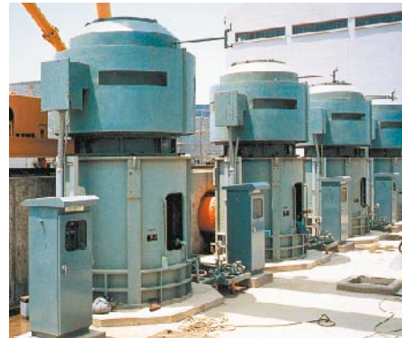
Vaporizing pumps in LNG Plant, Korea (Size:1,000mm, Driver:650kW)
